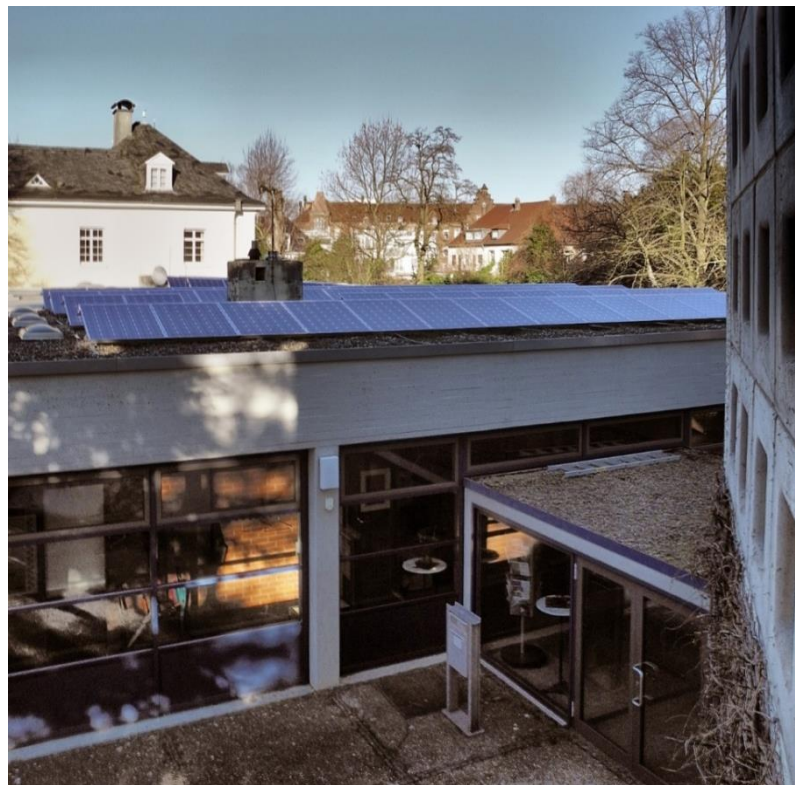
Abbildung: Die Photovoltaikanlage auf Kindergarten und Gemeindehaus
