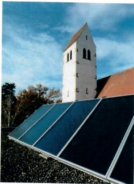
Solaranlage auf dem Pfarrhaus Hörblick
