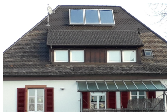
Pfarrhaus-Dach mit Solarthermie
