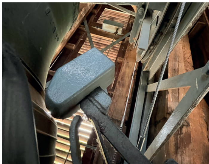
Zu großer und schwerer Fallhammer mit Rückprallfeder an der Bachert-Glocke von 1922 in der evangelischen Kirche Boxberg-Lengenrieden: Deutlich ist die Beschädigung am Wolk der Glocke zu sehen, wie sie durch das Aufschlagen bei der Zeitangabe entstanden ist.
